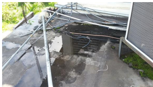
Agua Estancada debido a la Unidad del Aire Acondicionado y Moho.
