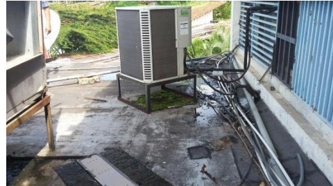
Agua Estancada del Aire Acondicionado.
