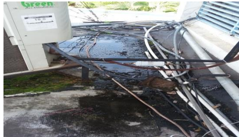
Agua Estancada debido a la Unidad del Aire Acondicionado.
